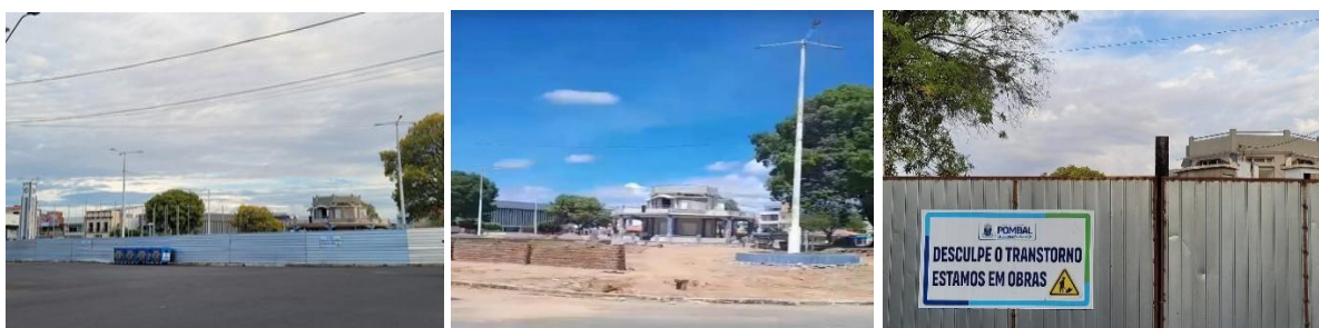
Figura 4 – Obra Embargada por Falta de Autorização da IPHAEP
