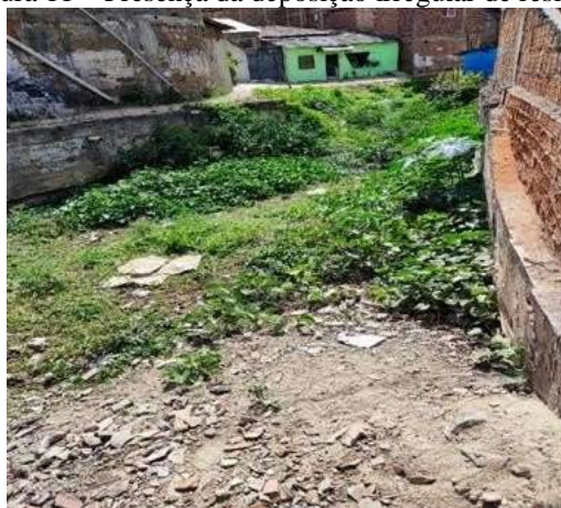
Figura 11 – Presença da deposição irregular de resíduos
