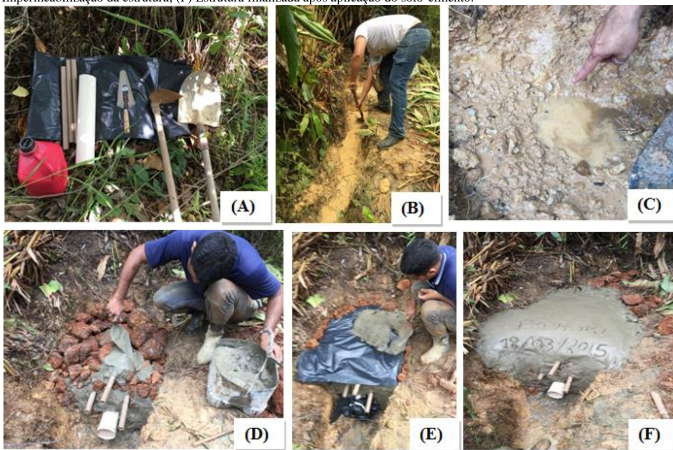
Figura 3. Etapas do processo de recuperação das nascentes. (A) Material utilizado; (B) Abertura da trincheira; (C) Identificação do olho d’água; (D) Construção da barragem com pedras alóctones junto à alocação dos tubos de PVC; (E) Impermeabilização da estrutura; (F) Estrutura finalizada após aplicação do solo-cimento.
